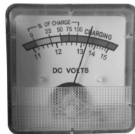
Figure 6 : La batterie est entièrement chargée
