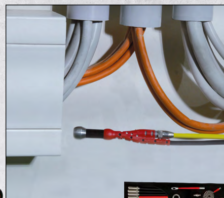
Schächte und Unterflurkanäle
